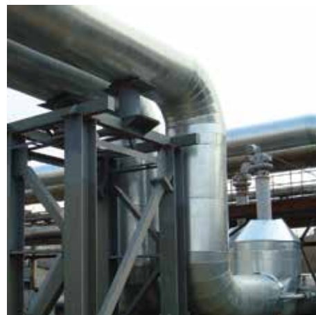
Системы вентиляции, кондиционирования и трубопроводы
